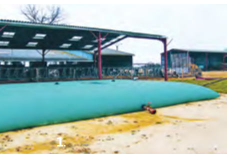
1. Пример установки резервуара на сельскохозяйственном предприятии. Typical installation in agricultural sector.
